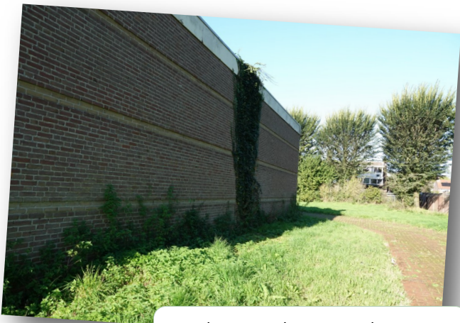
Te slopen gebouw op de locatie is vleermuizenverblijf
